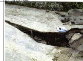
Uszkodzony fragment drogi gminnej oraz ziemny przyłącz prądu
