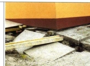
Uszkodzony budynek mieszkalny położony tuż pod skarą główną osuwiska
