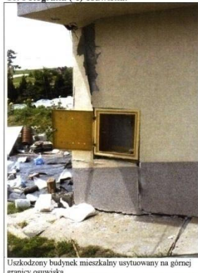
Uszkodzony budynek mieszkalny usytuowany na górnej granicy osuwiska
