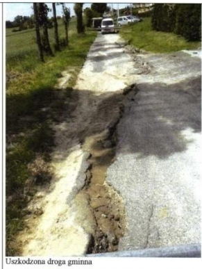
Uszkodzona droga gminna
