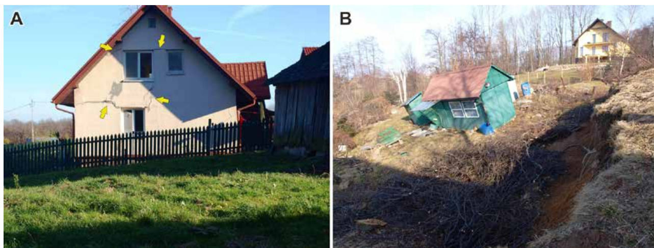
Ryc. 5. Skutki katastrofy osuwiskowej z 2010 r. na terenie Krakowa: A – uszkodzenia budynku mieszkalnego na osuwisku przy ul. Kuryłowicza (fot. A. Wójcik, 2010 r.); B – widok z skarpy głównej osuwiska przy ul. Golkowickiej. Fot. A. Wójcik, 2011 r.
